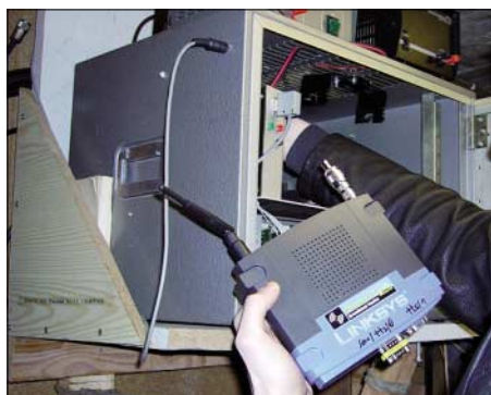
Einbau des WLAN-Routers
